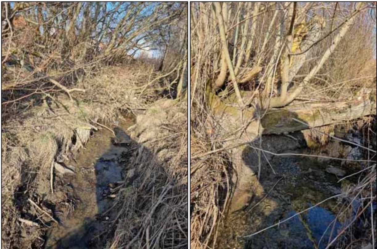
Figur 10-24 – Noterade erosionskador längs bäcken söder om Hedsvägen, Delområde 5 & 6.
