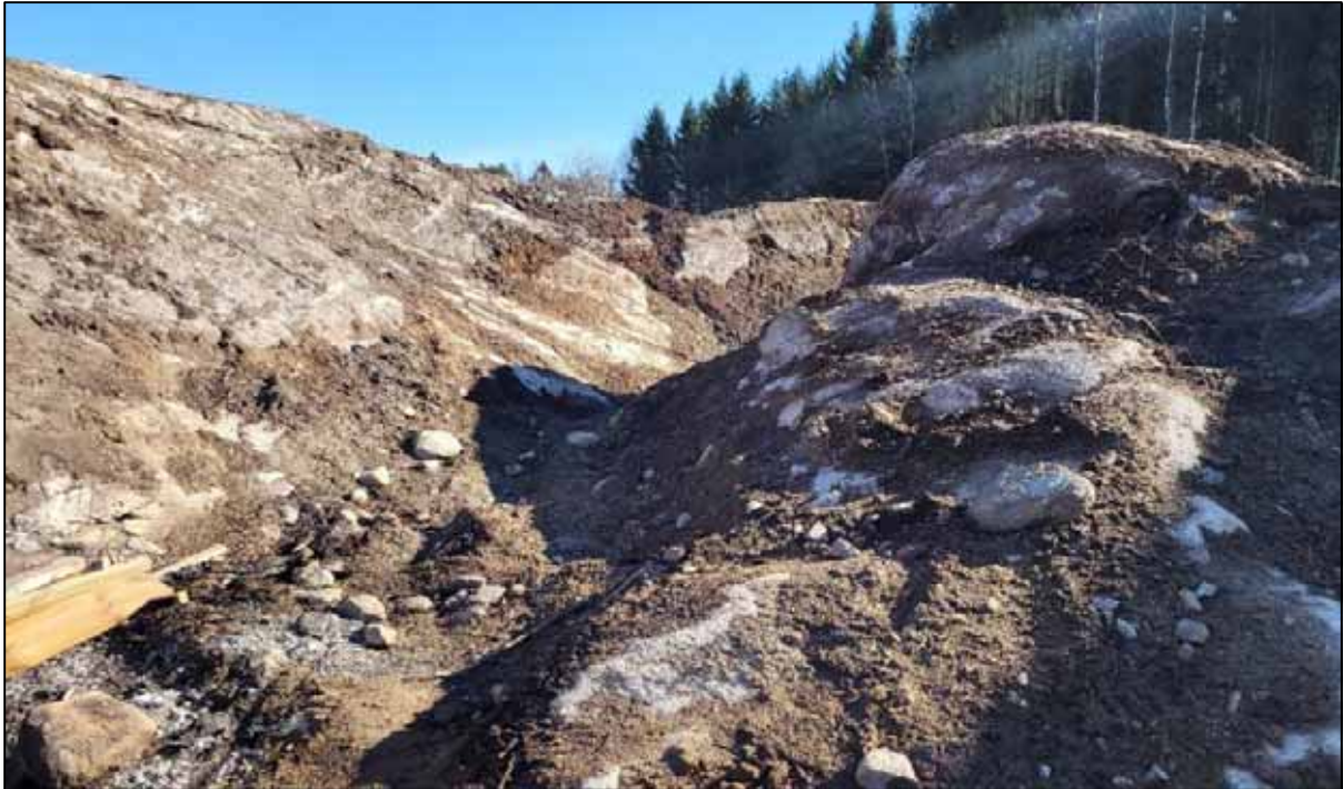
Figur 10-43 – Bergförekomst i södra delen av Delområdet 6. Spägning av berg och schaktarbete pågick i området under platsbesökets tillfälle.
