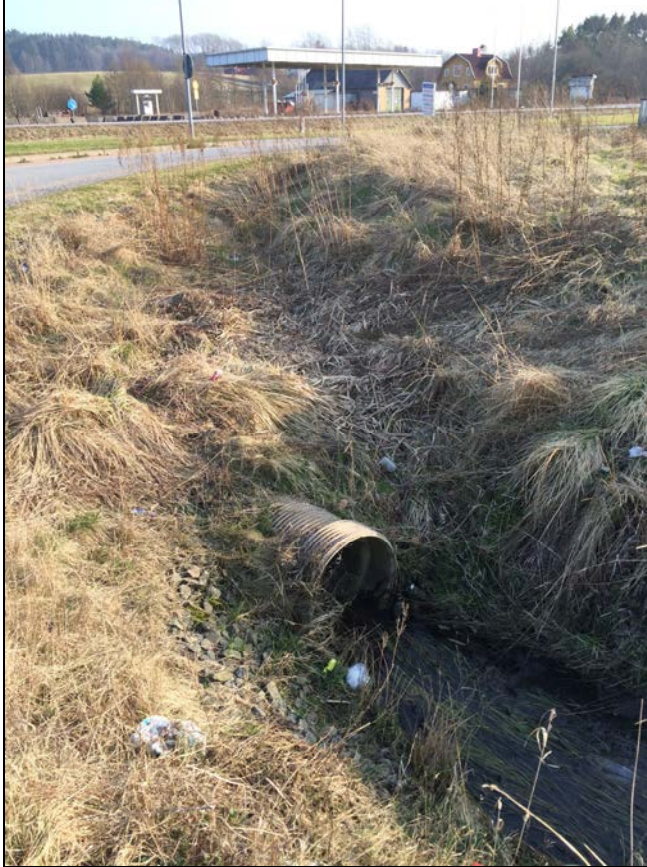
Figur 19. Dagvattentrumma AD500 från dike till dagvattentrumma AD600 under Romelandavägen
