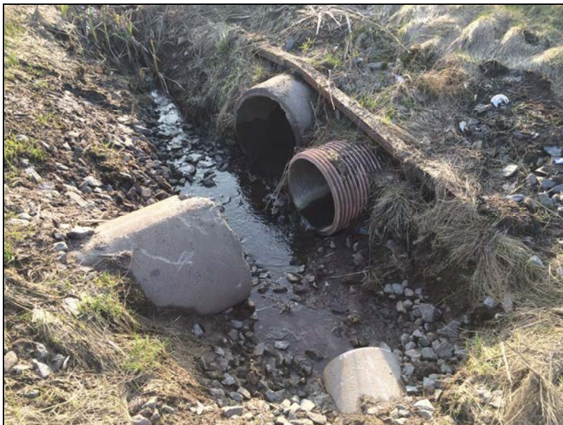
Figur 15. Dagvattentrumma AD600 till vänster i bild. Inloppstrummor från diken i området
