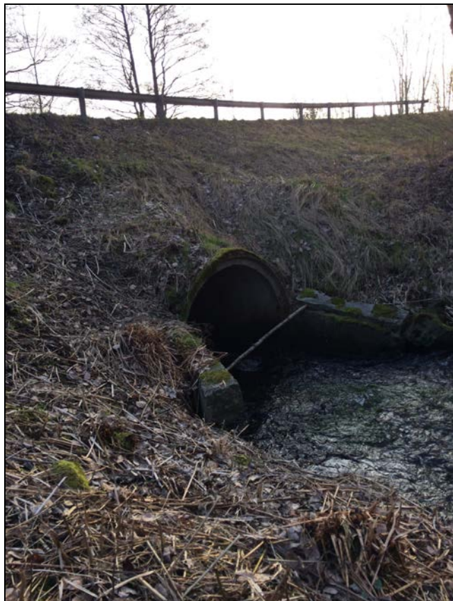
Figur 36. Dagvattentrumma under Prästvågen, MP1
