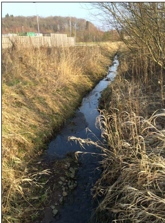
Figur 18. Dike inom Centrumtomten. Avvattnar delar av Diseröd norr om Centrumtomten vidare till dagvattentrumba AD600 under Romelandavägen
