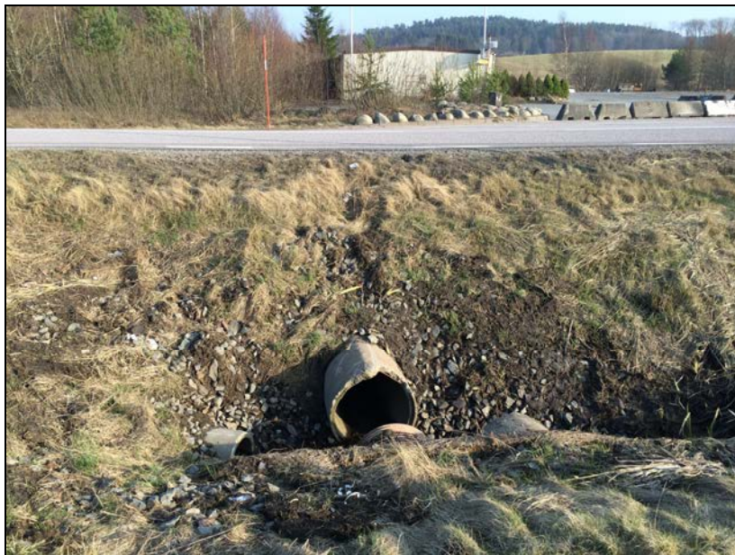
Figur 14. Dagvattentrumma AD600 under Romelandavägen.
