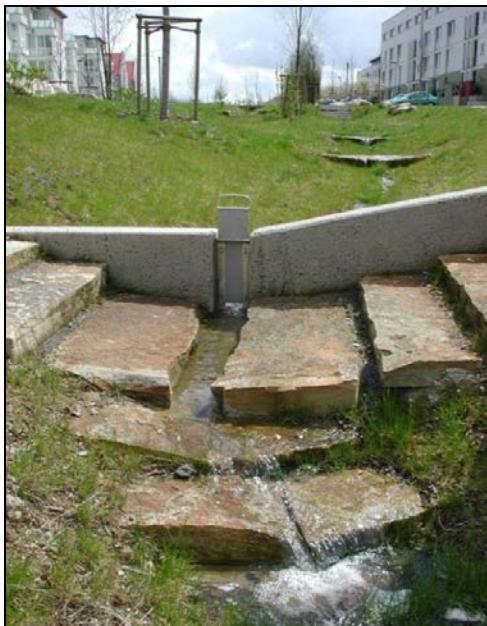
Figur 41. Dagvattendike med fördröjning och reglering i Kronsberg, Tyskland
