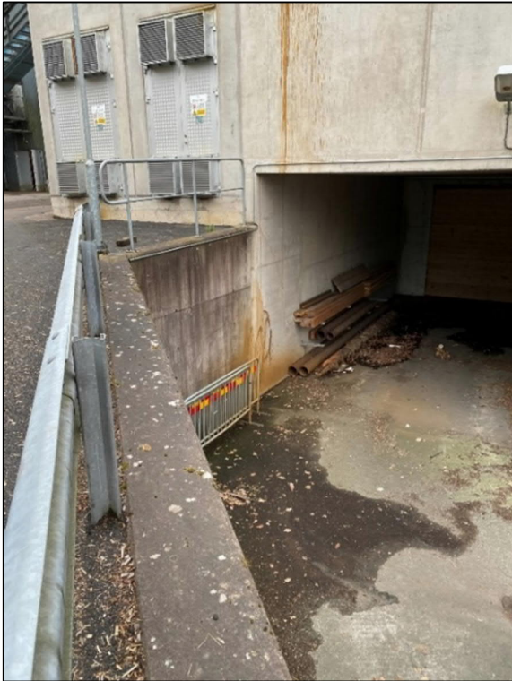
Figur 20. Låg betongkant som till viss del hindrar vatten från att rinna ner i befintlig lågpunkt.
