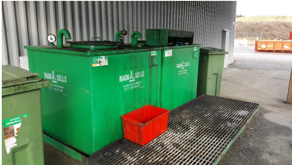
Figur 3. Tankar för mottagning av spillolja. Dessa kommer att ersättas med dubbelmantlade tankar.
