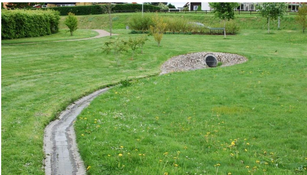
Figur 17. Exempel på en översvämningsyta med rännalsplattor. Foto: Sweco.
