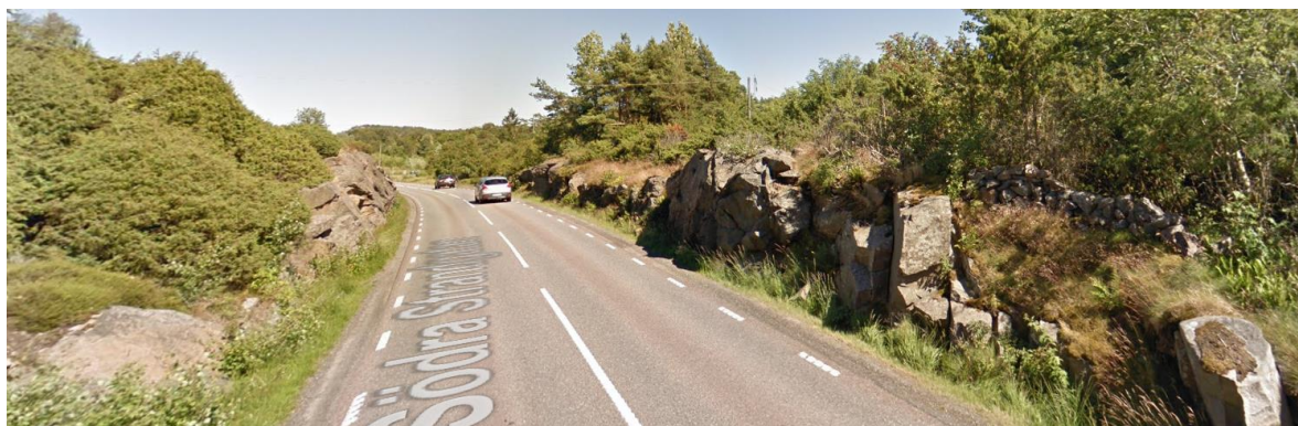
Berg i vägens sidoområde utgör en trafikfara. Planområdets västra del. (Foto: Google Maps)
