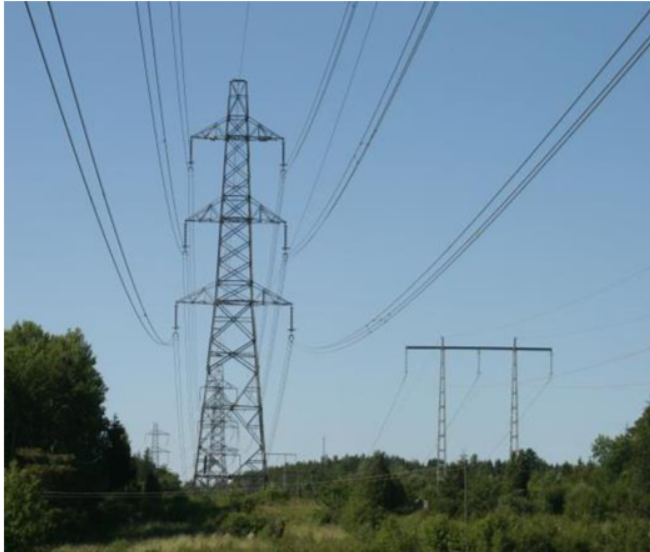
Figur 6. Illustration av julgransstolpe i stål bredvid en portalstolpe t.h.
